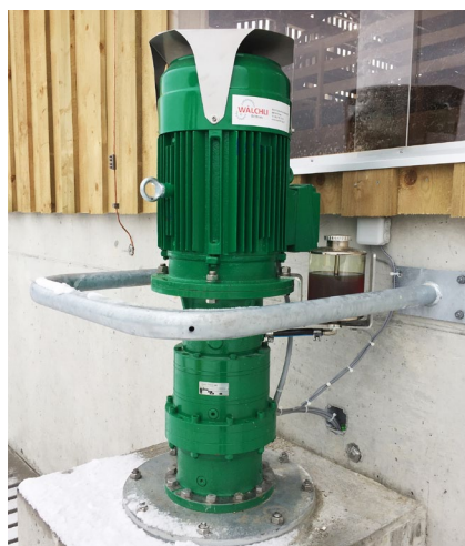
Antrieb direkt auf der Grubendecke
